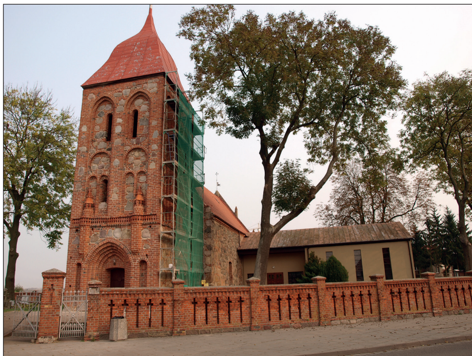
Ryc. 4. Prace remontowe elewacji wieży kościoła pw. Świętego Krzyża w dzielnicy Stargard – Kluczewo, wg stanu z 31 lipca 2017 r. Fot. A. Bierca, MAH w Stargardzie
