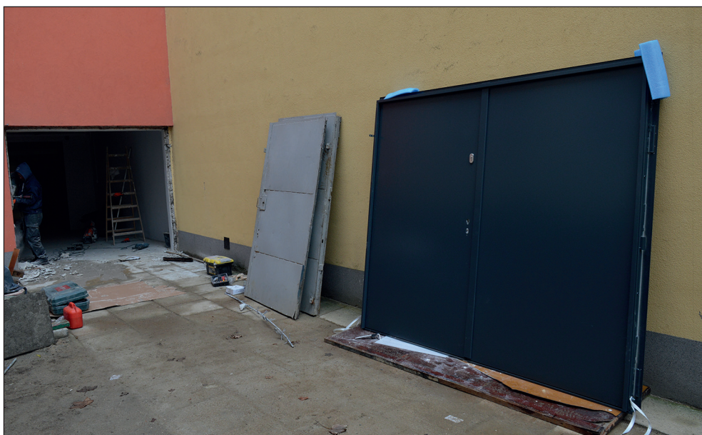
Ryc. 12. Czwarty etap prac remontowo-adaptacyjnych magazynu archeologicznego MAH w Stargardzie, wg stanu z 22 listopada 2017 r. Fot. A. Bierca, MAH w Stargardzie
